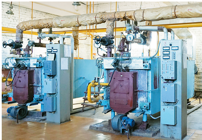
Газовая котельная в д. Пестрецово
